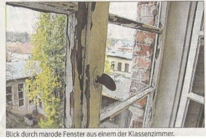
Blick durch marode Fenster aus einem der Klassenzimmer.
